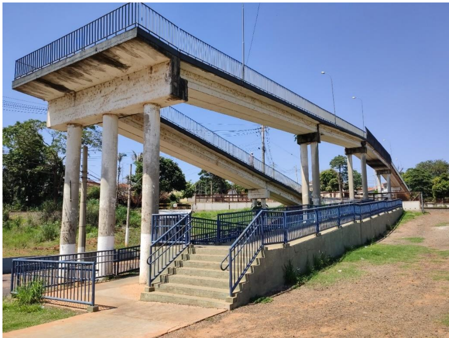
Imagem 101: Passarela. Fonte: Departamento de Turismo.
